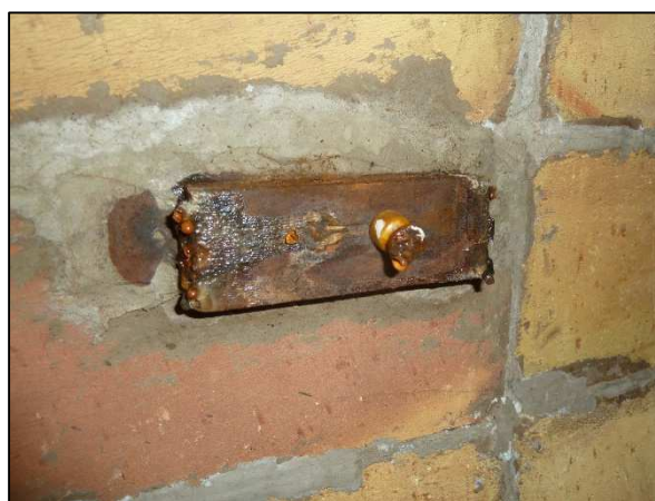
Detall de la única de les peces de fusta vinculades amb la instal·lació elèctrica que conservava un petit aïllant ceràmic vinculat amb aquesta.
