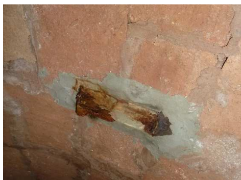
Detall del suport per al futur cablejat elèctric del refugi.
