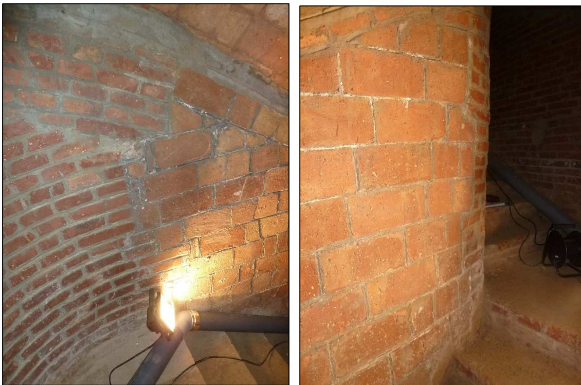
Vista del punt de contacte, en la zona del gir inicial del tram 3, entre els dos sistemes de col·locació de les peces ceràmiques de revestiment de la paret de l'escala, de pla als trams 1 i 2 i de cantell al tram 3. Es comprova també l'arrodoniment en el gir del mur.
