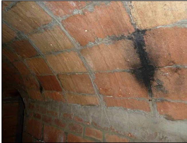
Detall de les taques de sutge que indiquen els punts de la il·luminació provisional del corredor.
