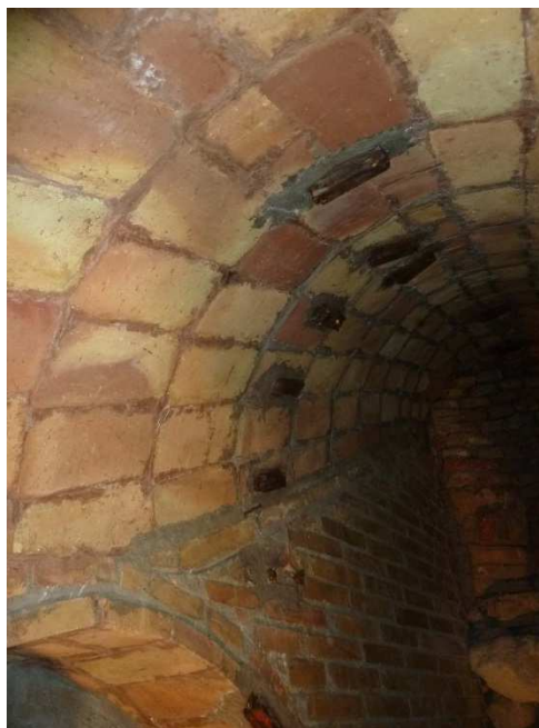
Vista d'una sèrie de suports per a la instal·lació elèctrica documentats a l'inici de l'escala 2.
