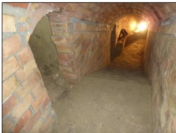
Vista del replà a l'escala 2 on s'obre (a l'esquerra) la porta que havia de donar accés a la Habitació 1
