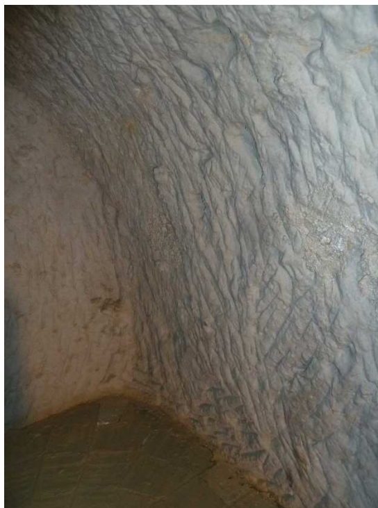
Detall d'una de les parets de la sala. S'observen les traces de la piqueta sota la pintura de calç blanca.
